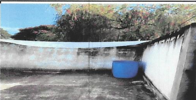
Foto 3: MÓDULO 3. Remozamiento de paredes y techo con hiladas de block con malla legitima.
